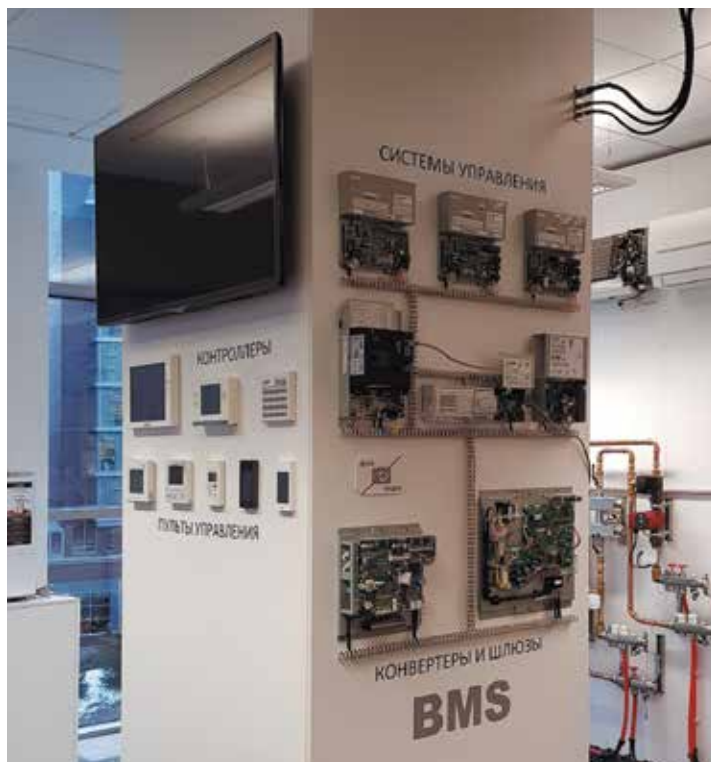
СИСТЕМЫ УПРАВЛЕНИЯ И ШЛЮЗЫ
